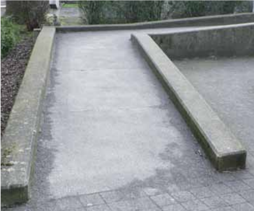
Durch die fehlenden Handläufe ist die Rampe insbesondere im Winter für Personen mit oder ohne körperliche Einschränkungen höchst unfallträchtig.
