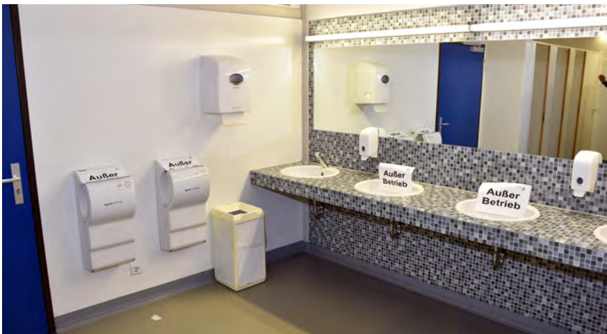
Bild 9: Abstände im Sanitärbereich und Sperrung Luftgebläse (Ersatz durch Papierhandtuchspender zur Vermeidung von Partikelverteilung)
